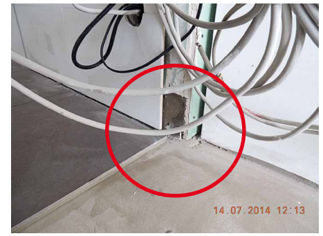
Abb. 6: Fußbodenabdichtung ohne seitliche Aufkantung
